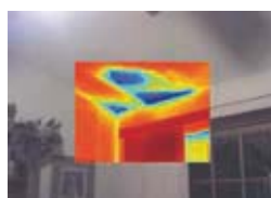
Chybějící izolace Rychlé vyhledání chybějící izolace v budovách.
